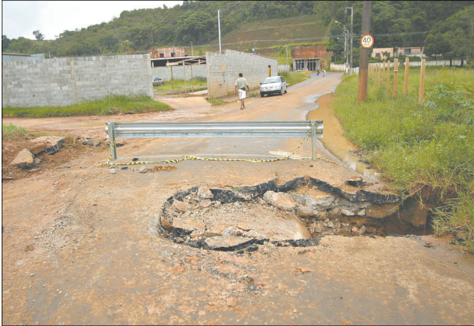
• Ponte de acesso à Rua João Krolman Sobrinho, no Bairro Parque São Pedro, está interditada
